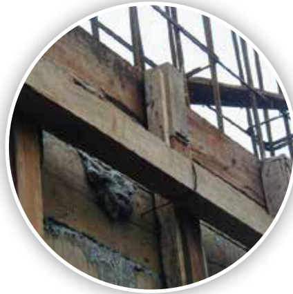
• Mala ejecución de los encofrados.
