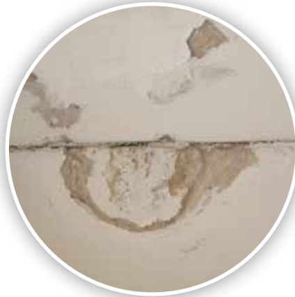
• Falla en la ejecución de la junta de dilatación.
