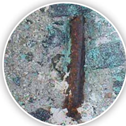
• Oxidación en armadura
